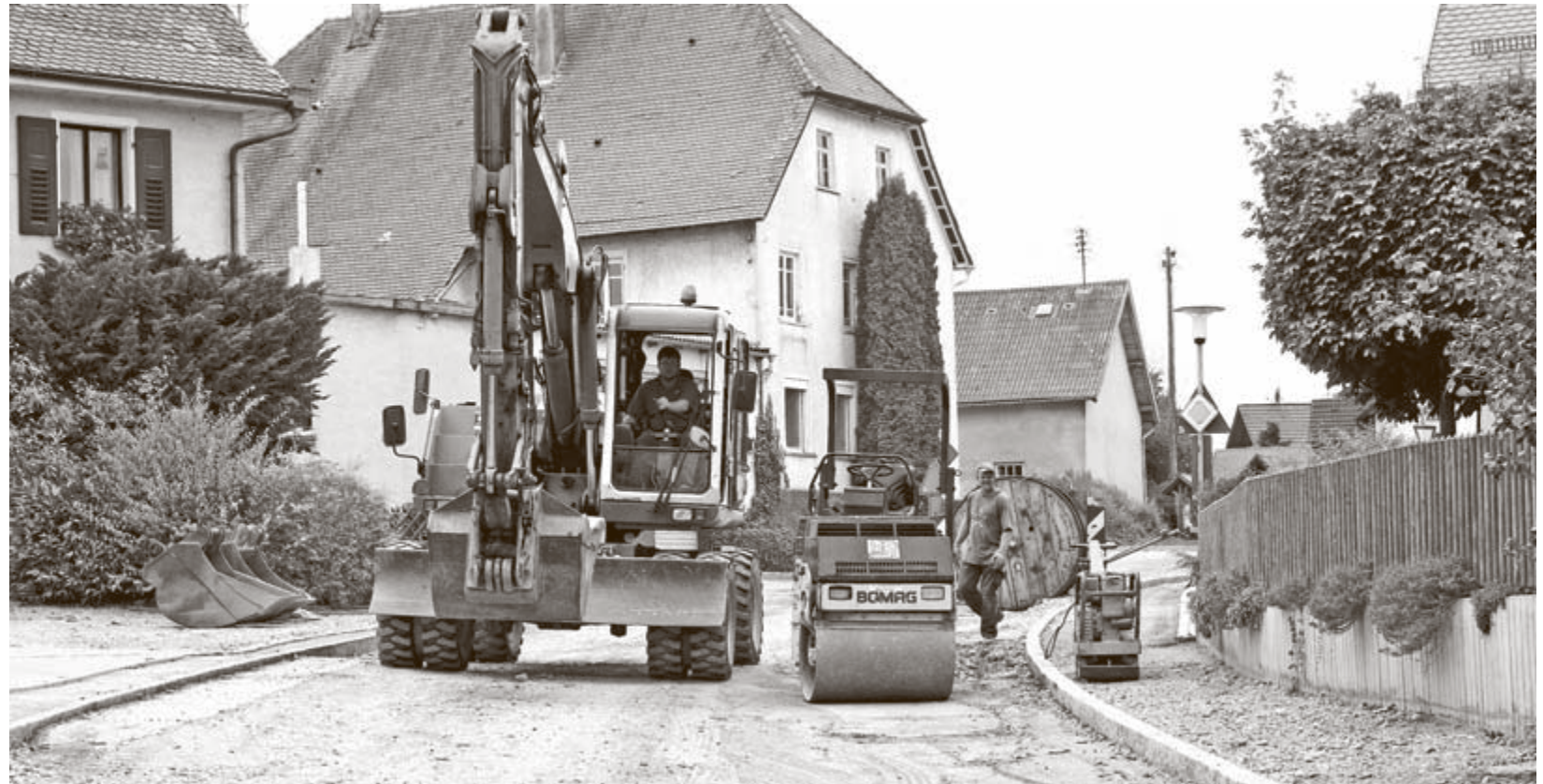
Der Ausbau der Ortsdurchfahrt in Bichtlingen stellt in diesem Jahr einen Kernpunkt im Investitionsprogramm des Kreises und der Gemeinde Sauldorf dar. Für die Erneuerung der Wasserleitung muss die Gemeinde nach Abzug der Zuschüsse 233 000 Euro bezahlen.
